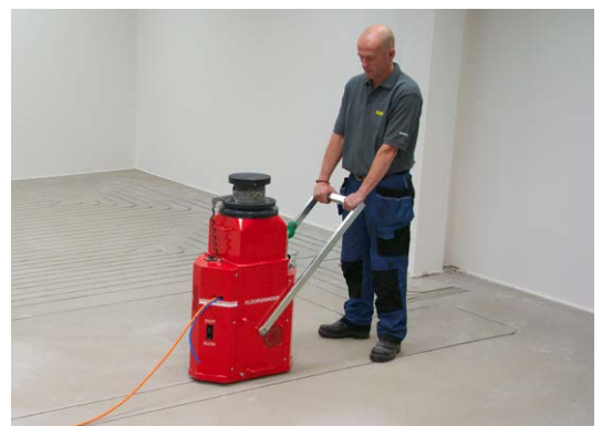
DAIKIN cut - Die Kanäle zur Verlegung der Heizrohre werden in den vorhandenen Estrich eingefräst
